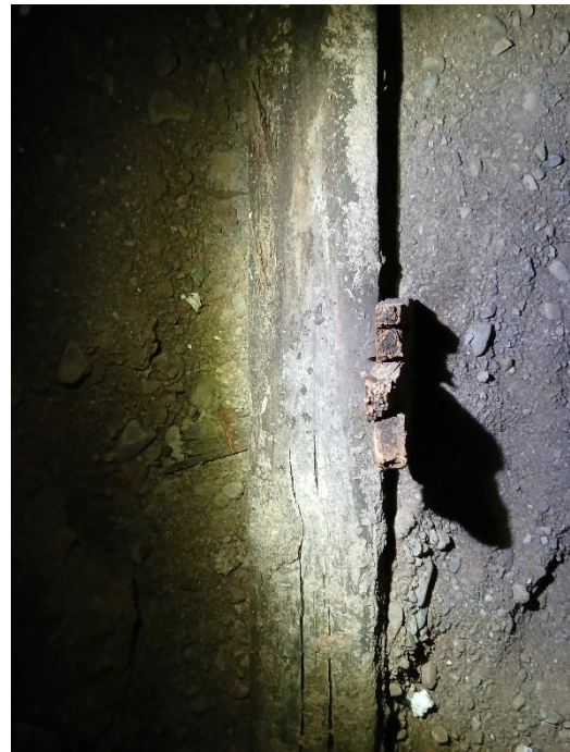
Alapohjassa vanhaa lahoavaa laudoitusta
