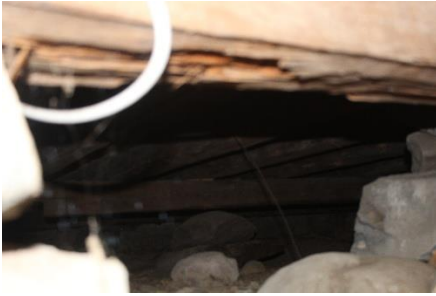
Alapohjan vanhoja lahovaurioita
