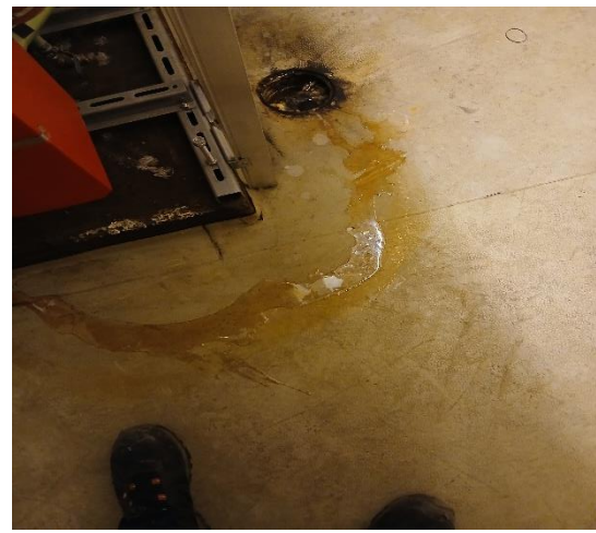
Pannuhuoneessa vesi juoksee suoraan lattiakaivoon.
