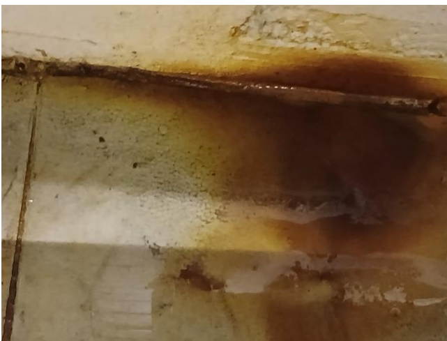
Pannuhuoneesta lattian ja seinän välistä tulee vettä.
