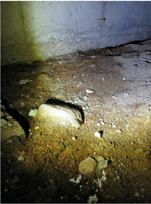
Alapohjan kosteaa hiekkaa
