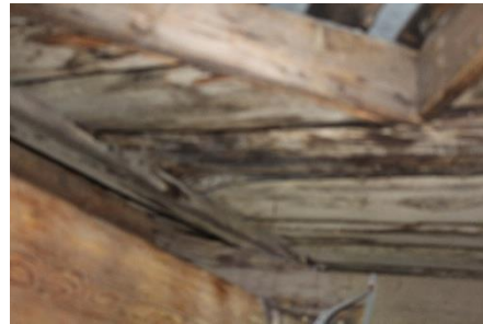
Kattorakenteen vanhoja vesivuodon jälkiä
