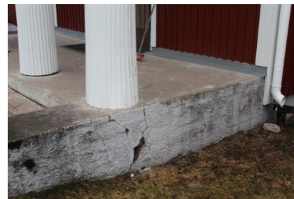
Sisääntulon laatassa korjattavaa, uusittu 2025.
